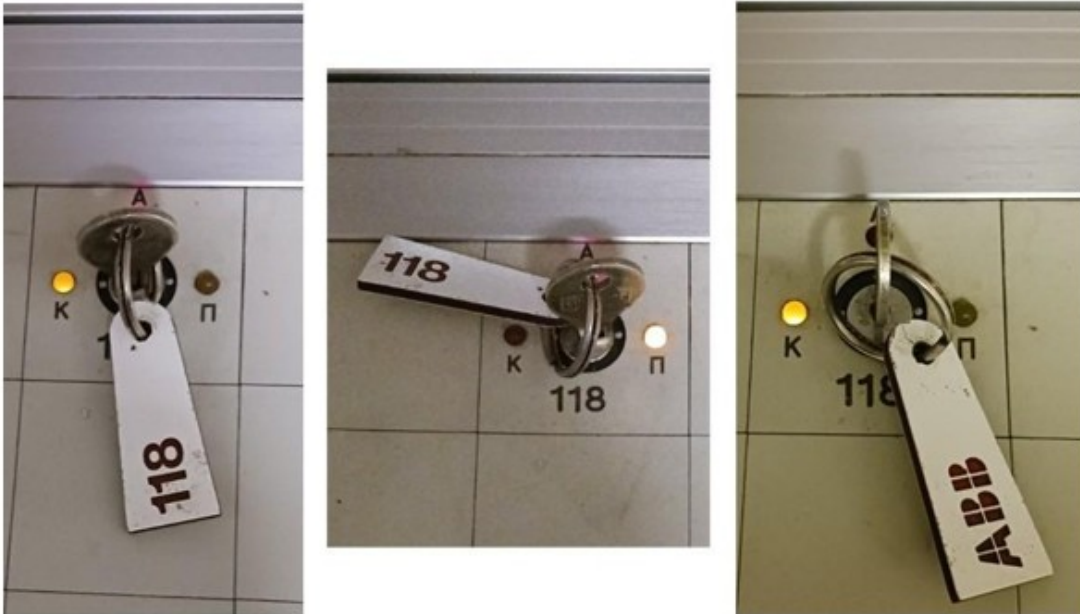
Εικόνα 46. Λεπτομέρεια του κλειδιού τριών θέσεων για το χειρισμό των διακοπών 118 στον Πίνακα Ελέγχου Λάρισας.
