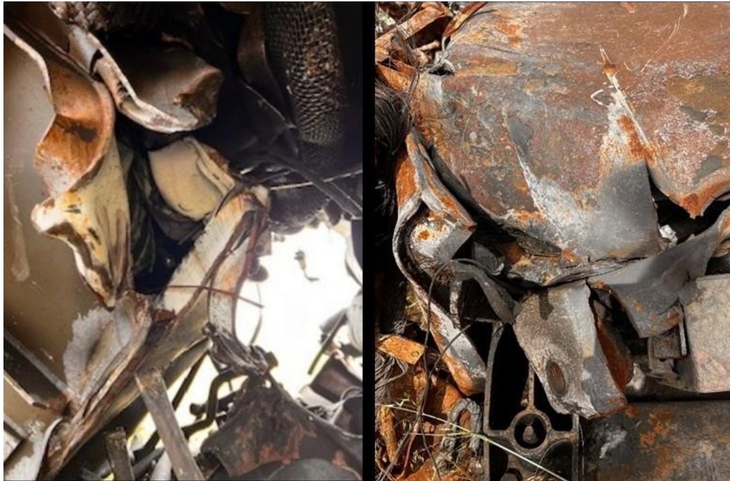
Εικόνα 67. Μεγάλες ρωγμές του μετασχηματιστή που είναι ακόμα προσαρτημένες κάτω από την ατμομηχανή 120-022 (Αριστερά). Προσκρούσεις, πτυχώσεις, σκισίματα και μεγάλες ρωγμές του εναπομείναντος μετασχηματιστή ατμομηχανής 120-023 (δεξιά), δείτε επίσης Εικόνα 61.
