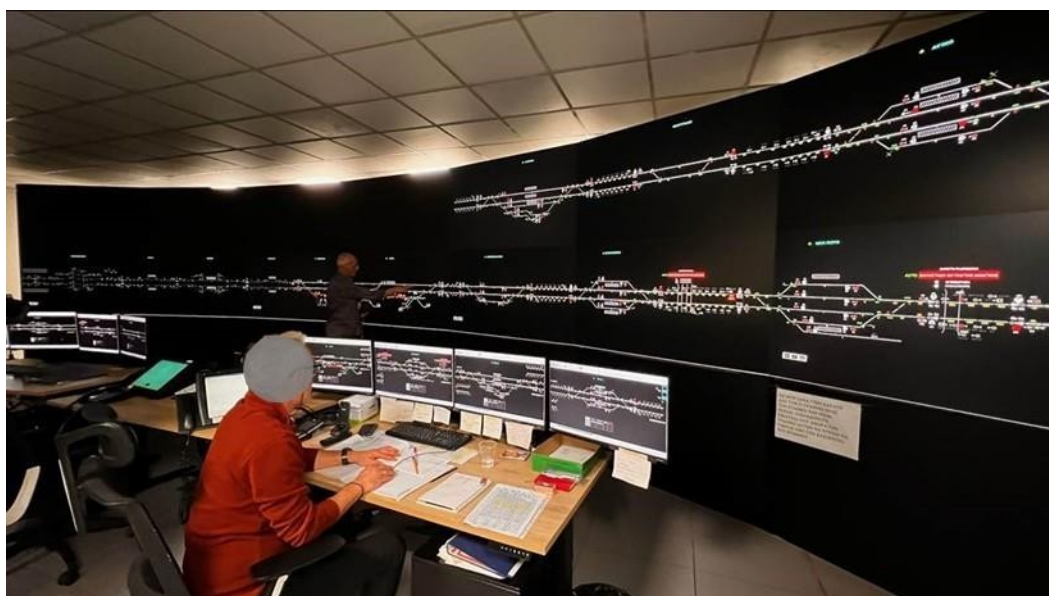
Εικόνα 52. Ψηφιοποιημένη αίθουσα ελέγχου κυκλοφορίας στο σταθμό Λαρίσης, με έμπειρο προσωπικό, το 2025.
